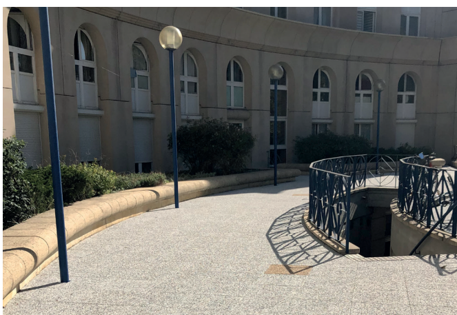
Réfection de l'étanchéité et des dalles du parvis de la résidence Corby, Clamart.
